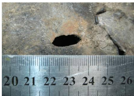
Рисунок 2 - Вид сквозного коррозионного отверстия с наружной поверхности трубы
